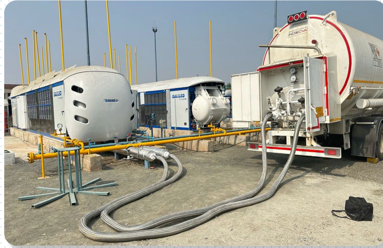
LNG Production commenced :16.11.2023
