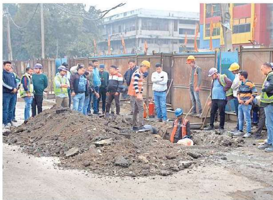
जीटी करनाल रोड पर लाल बाग के पास रोड की खोदाई कार्य के कारण फटी आइजीएल पाइप लाइन के मरम्मत कार्य में जुटे कर्मचारी
